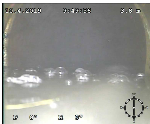
Obrázek 5: Snímek po 4m prohlídky po proplachu přípojky. Voda se akumuluje v potrubí bez výrazného odtoku (3)
