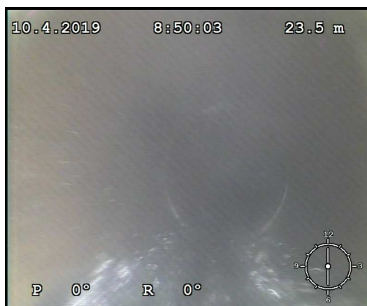
Obrázek 9: Snímek přípojky z prohlídky před čištěním (II), kdy se po 21m od revizní šachty nachází potrubí bez zadržené vody
