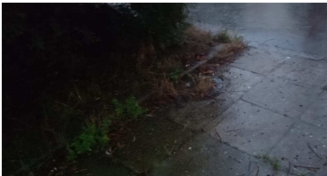
Obrázek 12 – Pohled na uliční vpust za deště na pozemku par. č. 3289/10 před vchodem č.p. 857
