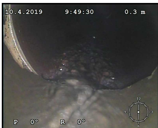
Obrázek 4: Snímek na začátku prohlídky po proplachu přípojky. Voda odtéká bez vzduší vody v kanalizaci (3)
