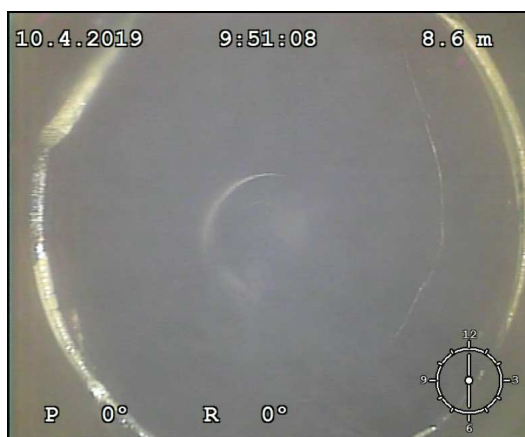
Obrázek 7: Prasklina potrubí na pravé straně (3)
