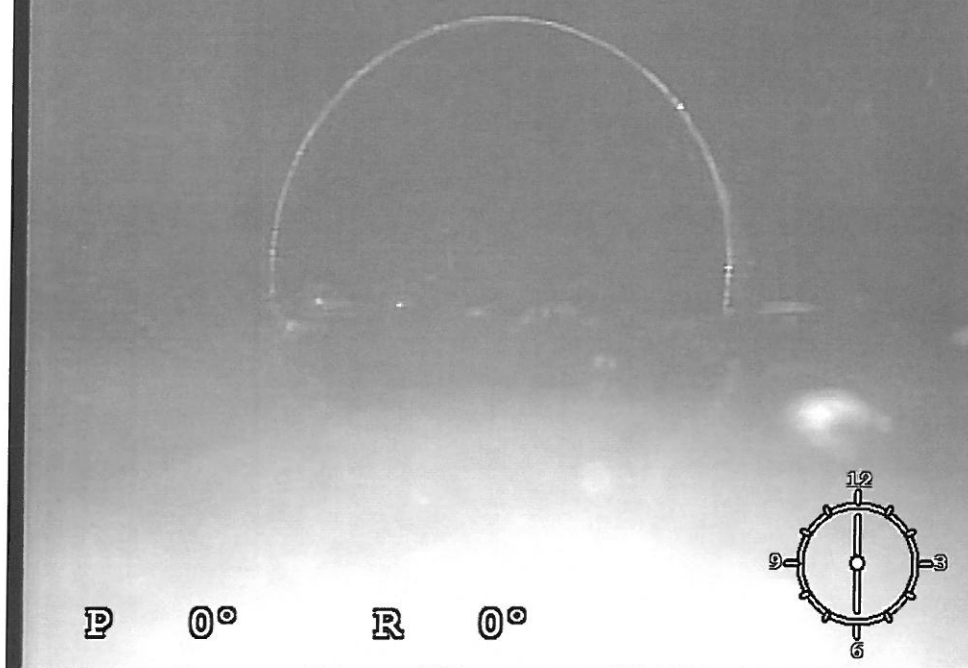
Obr. 9: Vzduťá voda ve vyčiřtřeném potrubí v profilu 4,4 m od revizní řachty po směru toku – foto ze záznamu po vyčiřtření přípojky [11]
