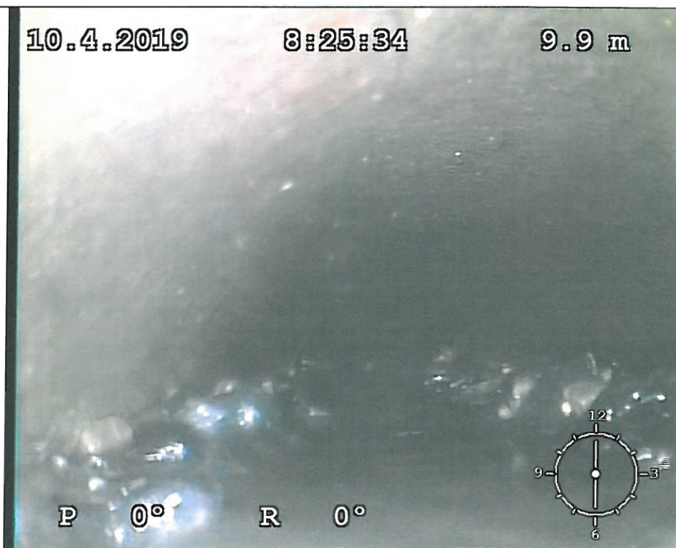
Obr. 4: Naplavený materiál v úseku potrubí za zaústěním pravděpodobně uliční vpusti – foto ze záznamu před vyčištěním přípojky [10]
